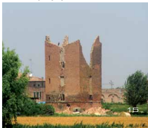
Fig. 2. Torre lesionata a Rovereto di Novi (MO).
