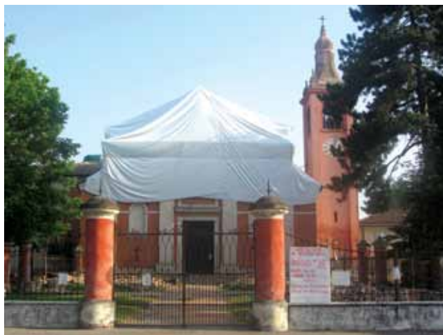
Fig. 7. Chiesa di Rivara di San Felice sul Panaro (MO), coperta da un telo in seguito al crollo del tetto.
