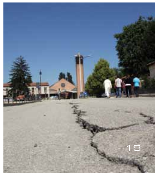
Fig. 2. Crepe nell'asfalto nella piazza principale di San Carlo (FE).
