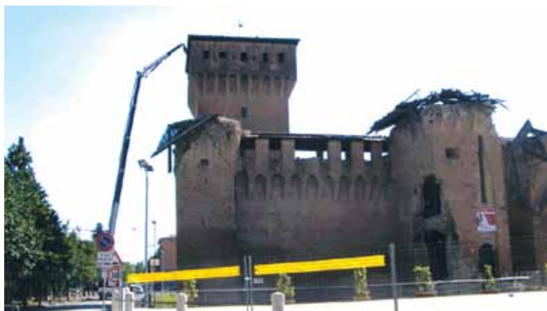
Fig. 5. San Felice sul Panaro (MO), la rocca danneggiata dalle scosse del 20 e 29 maggio.
