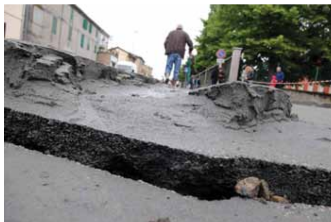
Fig. 8. Anche l'asfalto si è sollevato a San Carlo (FE).
