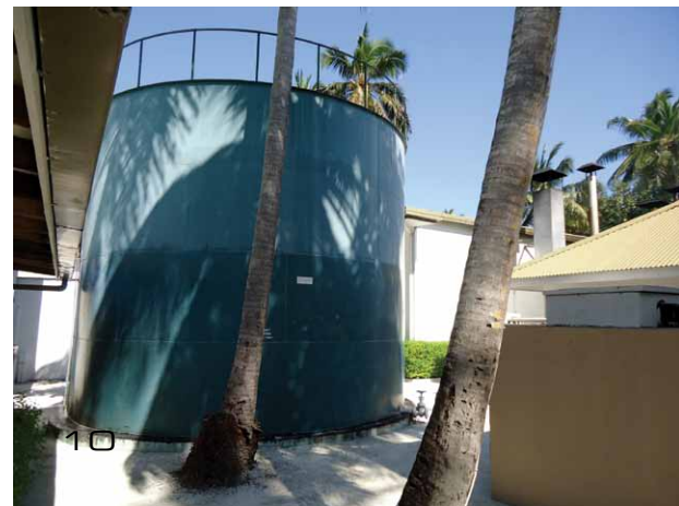
Fig. 4. Serbatoio d'acqua al resort Velavaru (Foto dell'autore).
