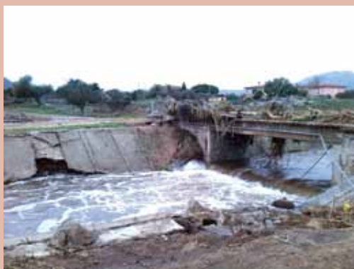
Olbia, Mercoledì 20 novembre: ciò che rimane di un ponte sul Rio Siligheddu nel quartiere Isticadeddu.
