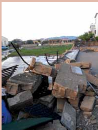
Olbia, martedì 19 novembre: il giorno dopo l'alluvione, ciò che resta del muro di cinta di un condominio in via Ragusa nel quartiere Bandinu (Foto: Maria Rocca).
